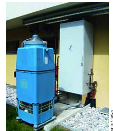
Absorptionskältemaschine chillii® PSC10 des Trainingscenter und Bürogebäudes BachlerAustria
