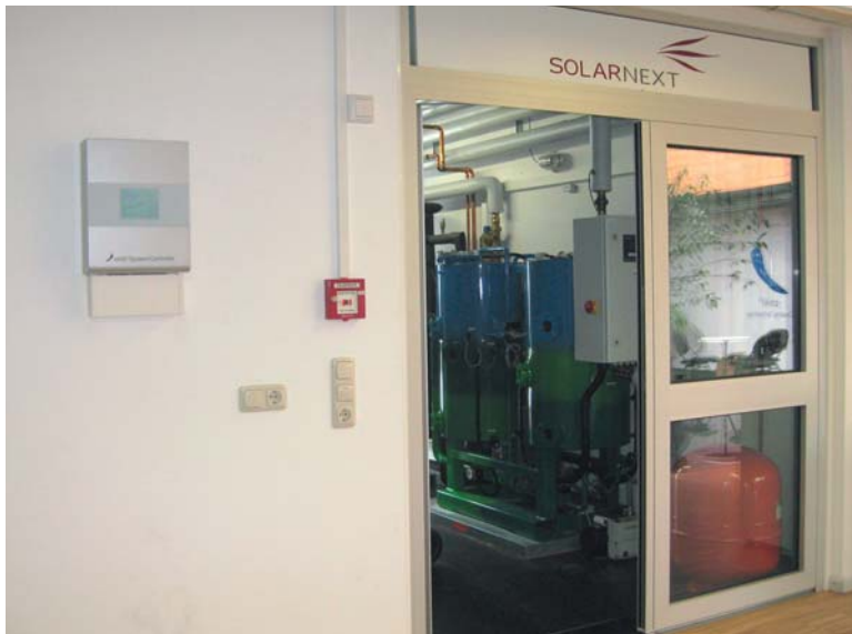
chillii® System Controller HC und Absorptionskälte- maschine chillii® ESC 15 des solaren Kühlsystems der Hightex GmbH
