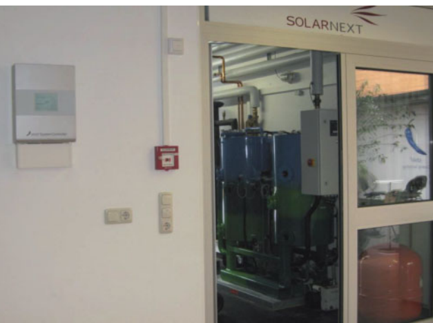
chillii® System Controller HC und Absorptionskältemaschine chillii® ESC15 des solaren Kühlsystems der Hightex GmbH (Foto: SolarNext)
