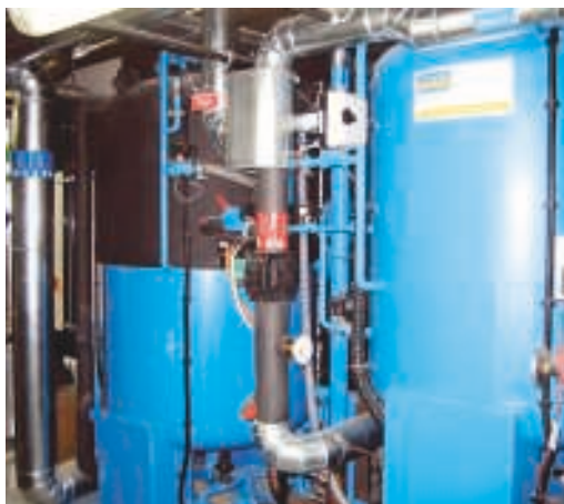
Eine durch CPC-Kollektoren angetriebene EAW-Absorptionskältemaschine sorgt im Museum Ritter in Waldenbuch für angenehmes Raumklima, wenn die Hauptkühlung durch Erdkälte nicht ausreicht. Foto: EAW
